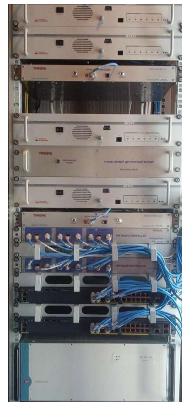
Пример реализации базовой станции ГМССБ морского района А1, работающей в составе комплекса NAVI GMDSS 4000 с использованием ПО «NAVI RADIO»
