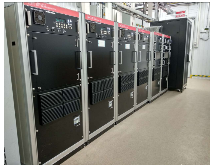
Оборудование передающего центра системы ГМССБ МР А2 порта Сабетта
